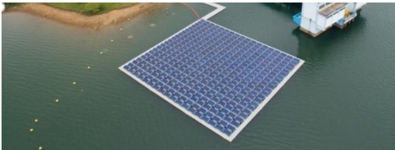
Figura 1. Usina fotovoltaica flutuante no reservatório de abastecimento de água, Passaúna (PR).
